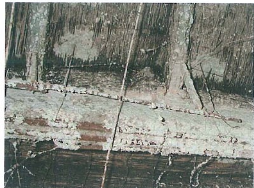
Schäden an Rohdeckenuntersicht, Rippen, Unterzügen
